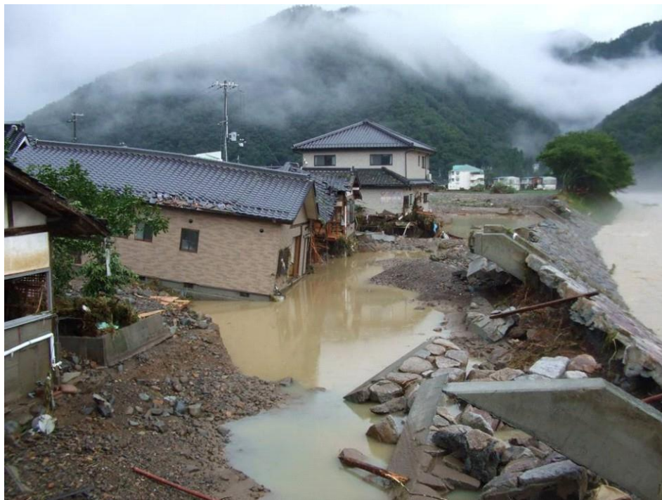
護岸崩壊状況（作用川・兵庫県）
