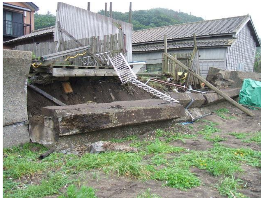
平成19年新潟県中越沖地震による パラペット被害 (宮川海岸・新潟県)
