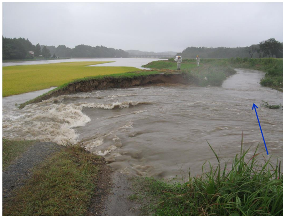
堤防の決壊状況（照越川・宮城県）
