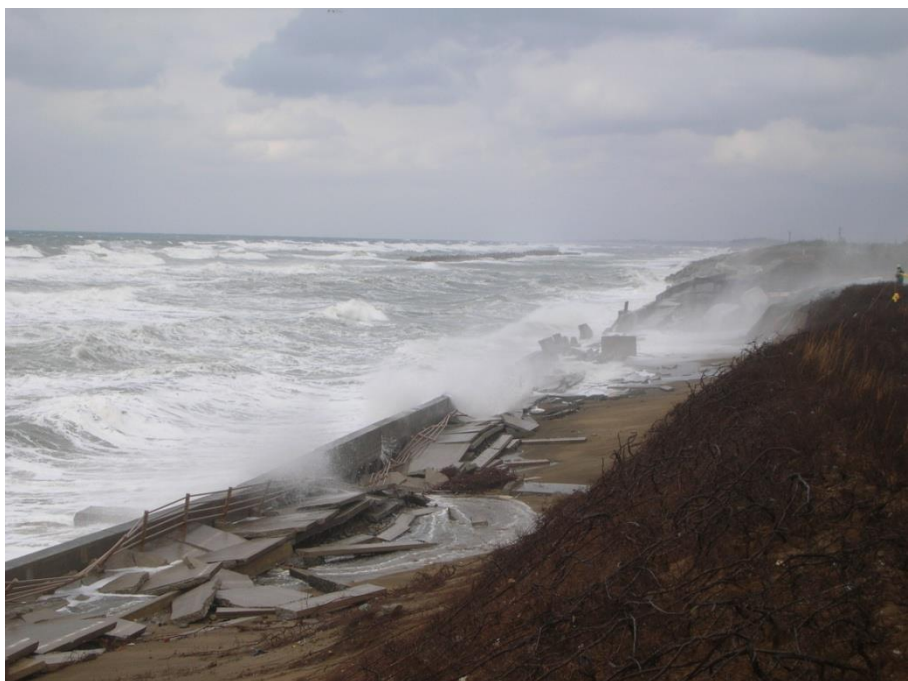
風浪による海岸堤防の被害 (片山津海岸・石川県)
